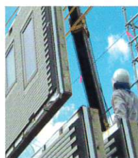
外壁パネルを工場で作った状態で出荷し、現場の作業を効率化
